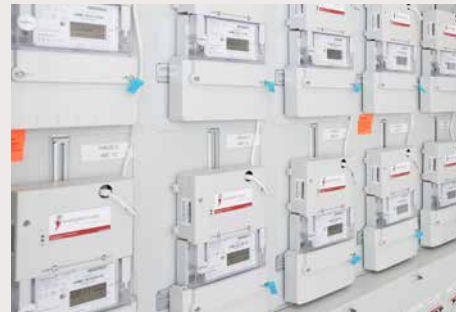
Datenerfassung über Smart Meter zur Anlagen- und Laufzeitenoptimierung
