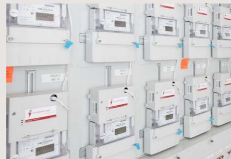
Datenerfassung über Smart Meter zur Anlagen- und Laufzeitenoptimierung
