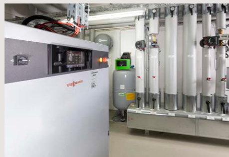
Energiesysteme stellen eine Vielzahl an Messwerten zur Verfügung.
